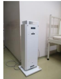
医務室・待機部屋 空気循環式紫外線殺菌機設置
